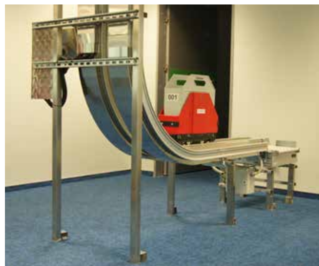
System transportu książek - stacja w czytelni na I piętrze
