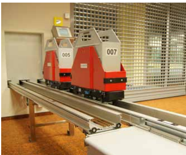
System transportu książek - stacja w wypożyczalni na parterze
